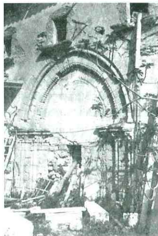
Portale dell'ex chiesa di S. Maria della Stella, prima del recente restauro.
