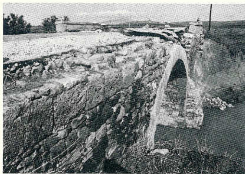
Quello che resta del Ponte Bordino dopo l'alluvione
