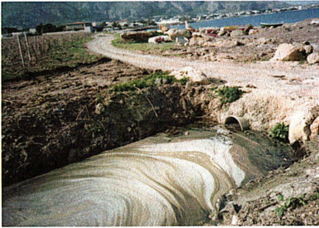
Degrado del Canale Misericordia, a Valderice (arch. fotograf. di G. Ettari).
