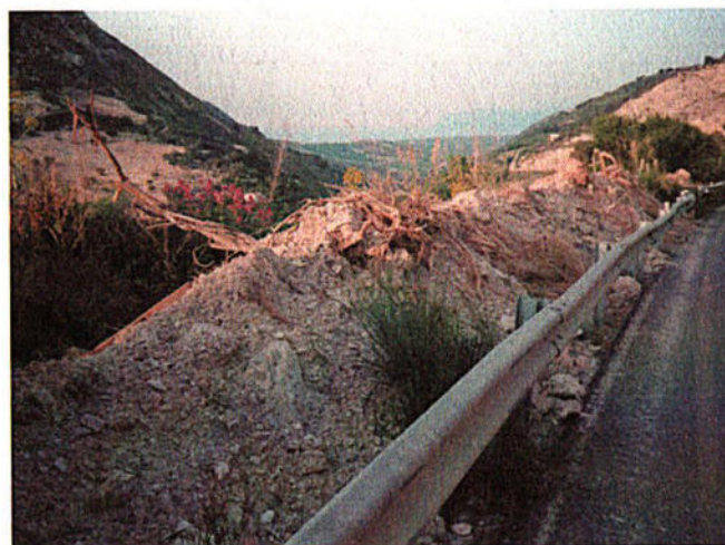
Statale 187 Trapani-Castellammare del Golfo, 27° km.: materiale di risulta abbandonato al di là del guard-rail, proveniente da lavori di grigliatura effettuati sul costone roccioso prospiciente la strada (arch. fotograf. di G. Ettari).
